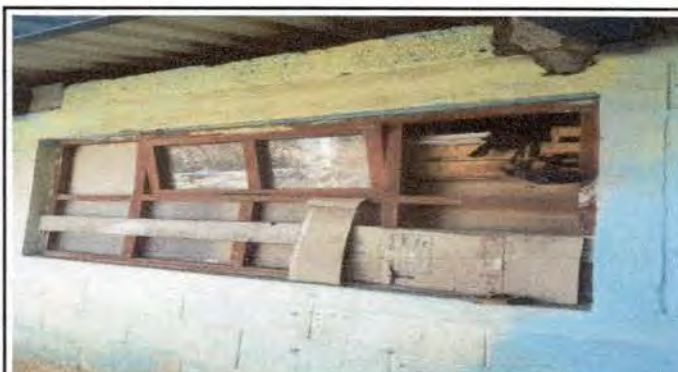
FOTO 4: VENTANAS DETERIORADAS POR EL TIEMPO.
