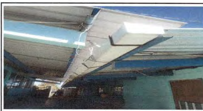
CANAL: DETERIORADO POR EL TIEMPO.
